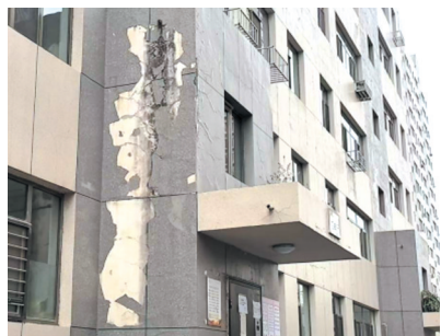
忻府区汾源后街光明小区居民楼墙皮破损
