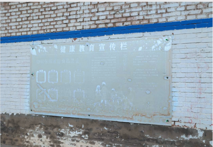
忻府区大檀村北大街公益广告牌破损、褪色。
