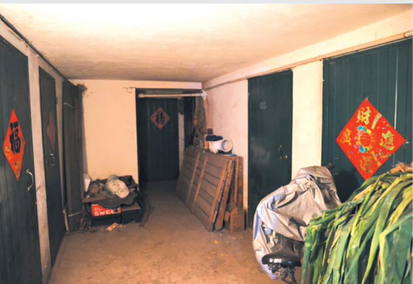
忻府区汾源东街南四巷金鹰小区楼道堆放杂物。
