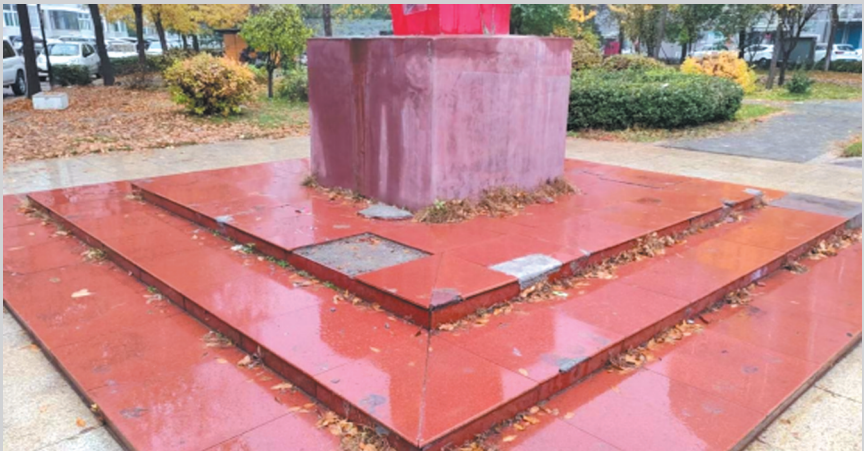
忻府区九原西街惠民小区16号楼北侧广场中心地砖缺失
