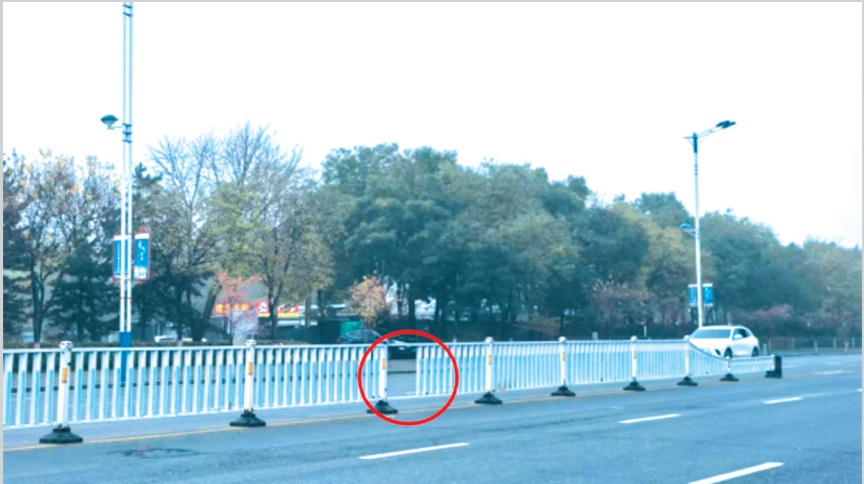
忻府区云中北路与汾源东街交叉口附近栏杆破损
