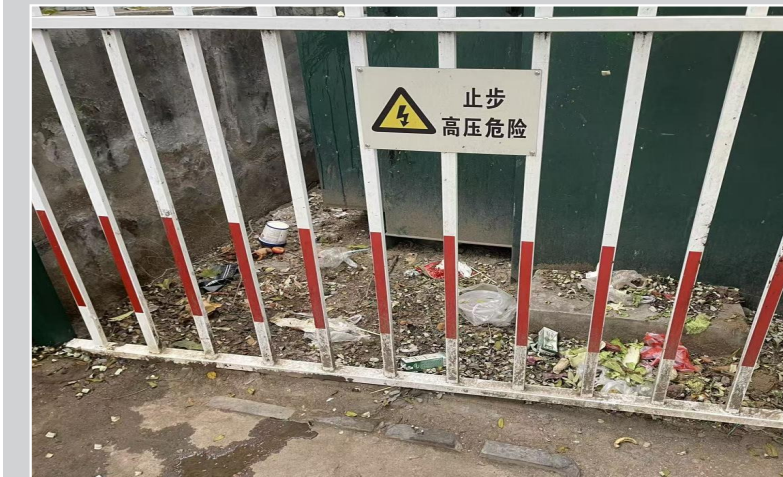
胜利住宅苑门口电箱内垃圾多
