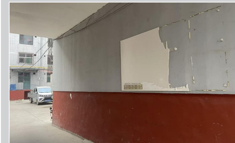
供销小区公益广告牌破损
