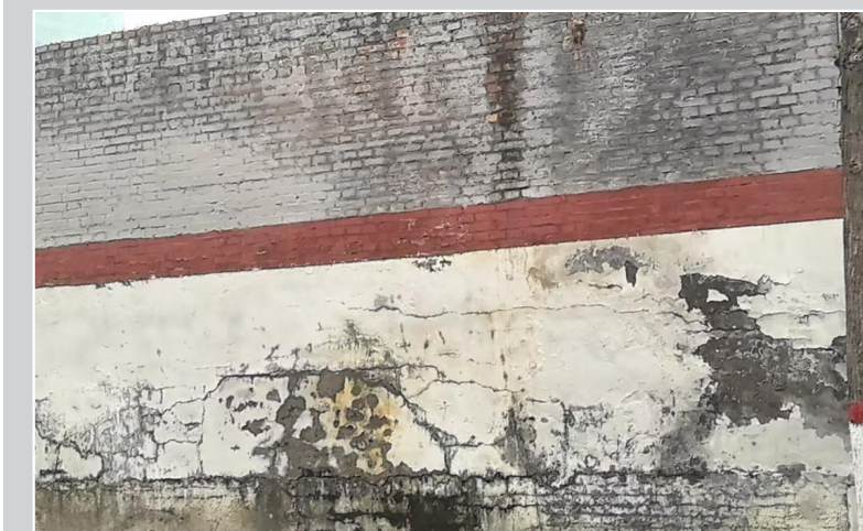
汾源东街南一巷墙皮脱落
