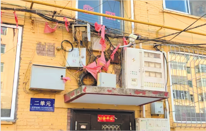
新建东街五公司家属院线缆凌乱。
