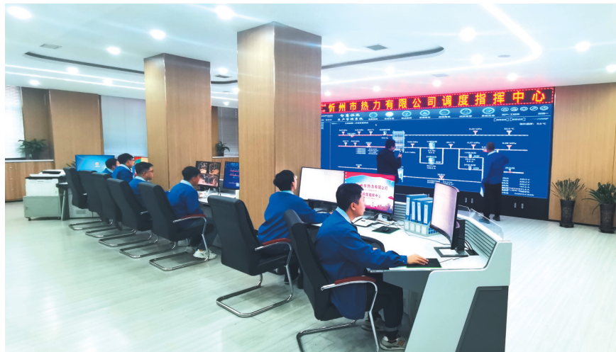
市热力公司人员在调度指挥中心全程监控城区供热管网运行情况。 张志强摄
