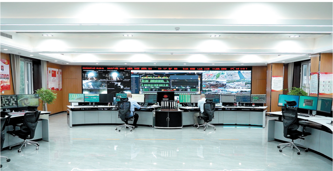
上榆泉煤矿智能化调度集控室。 河曲县融媒体中心供图
