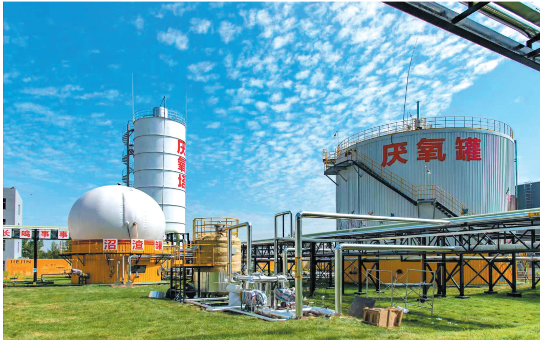
忻州市洁晋发电有限公司餐厨废弃物资源化利用项目。
