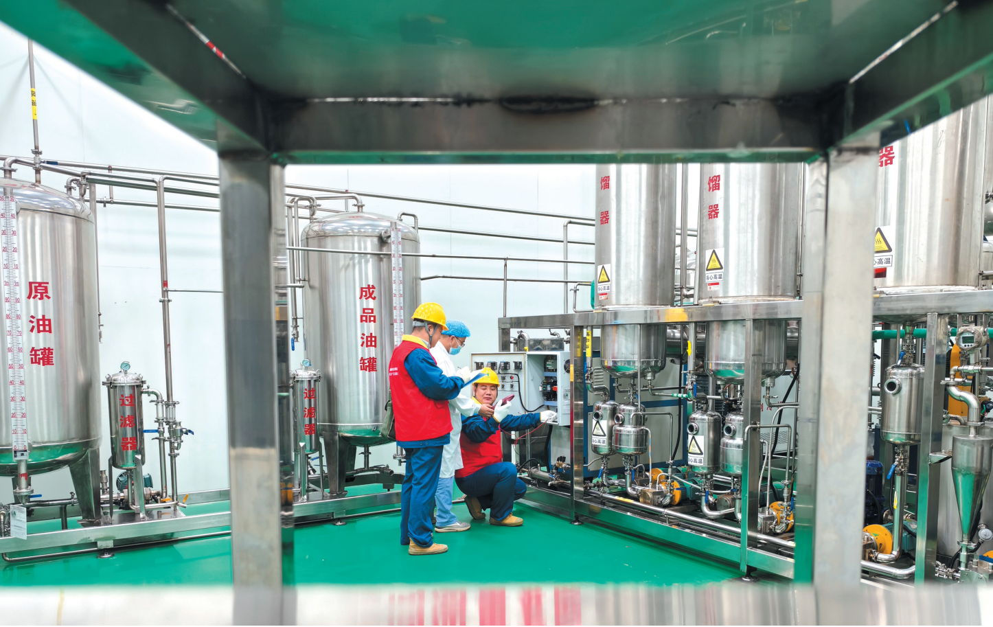
近日,国网五台县供电公司工作人员主动深入一线上门走访,详细了解企业用电负荷等情况,及时解决客户在用电方面遇到的困难和困惑,同时帮助客户进行安全隐患排查,进一步提升企业的安全生产用电意识和应急处置能力。图为供电公司共产党员服务队深入五台山沙棘制品有限公司,对办公场所、配电室、生产车间内配电柜的接线端子等部位进行检查。 孙立新摄
