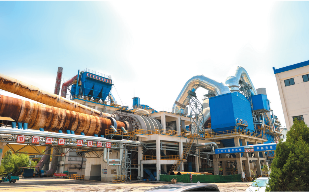
金隅台泥(代县)环保科技有限公司场内避冷机。
