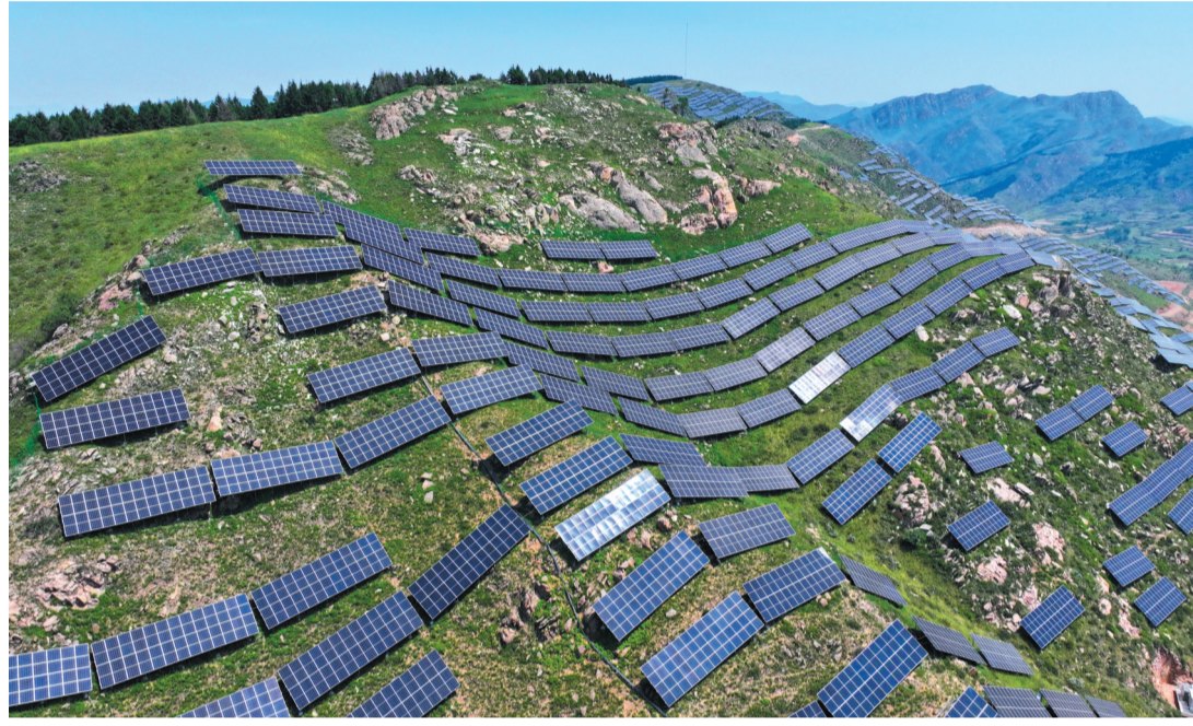
建在山坡上的原平市160MW光伏产业融合发展项目已并网发电。 本报记者 张存良摄
