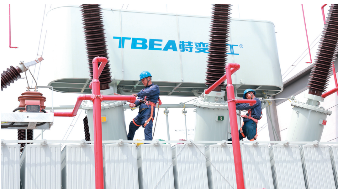
7月1日,随着两台主变压器并网运行,位于代县最营镇西高泉村的220千伏显旺变电站正式投运。图为技术人员进行投运前的最后检验。
